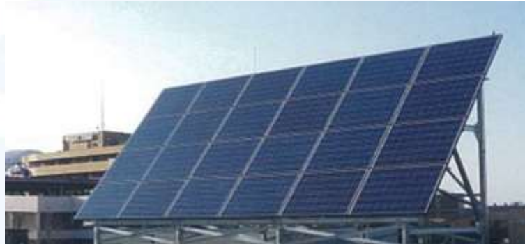
札幌市手稲区区役所 (2011) 最大出力 : 9.84kW
