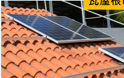
瓦屋根に設置
