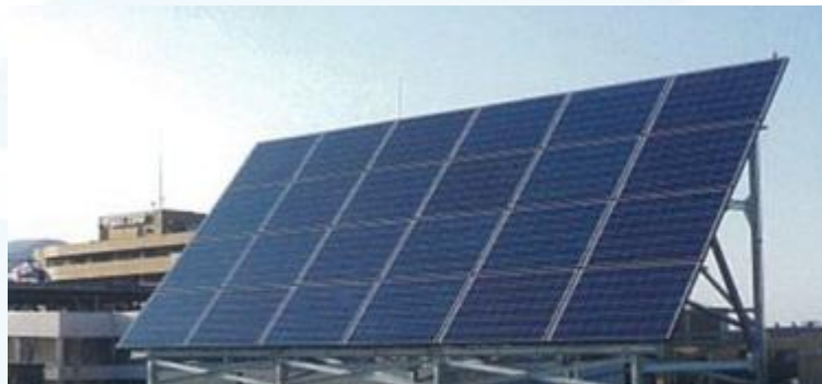
札幌市手稲区区役所 (2011) 最大出力：9.84kW
