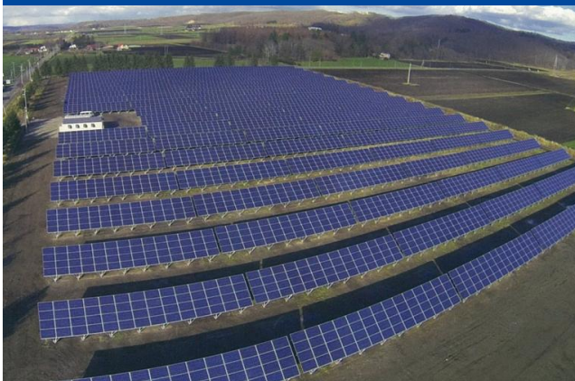
北海道 池田PV(2013) 最大出力：999.6kW
